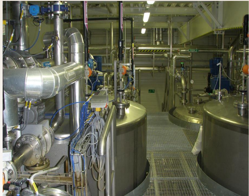
drożdżownia w Czechowicach -Dziedzicach
